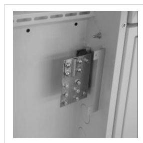
В канале КЭТ установлены шины N и PE
